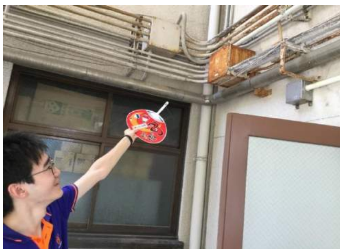
写真④：錆びた電気配線箱
