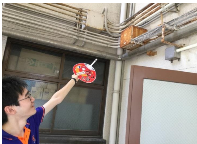
写真④：錆びた電気配線箱
